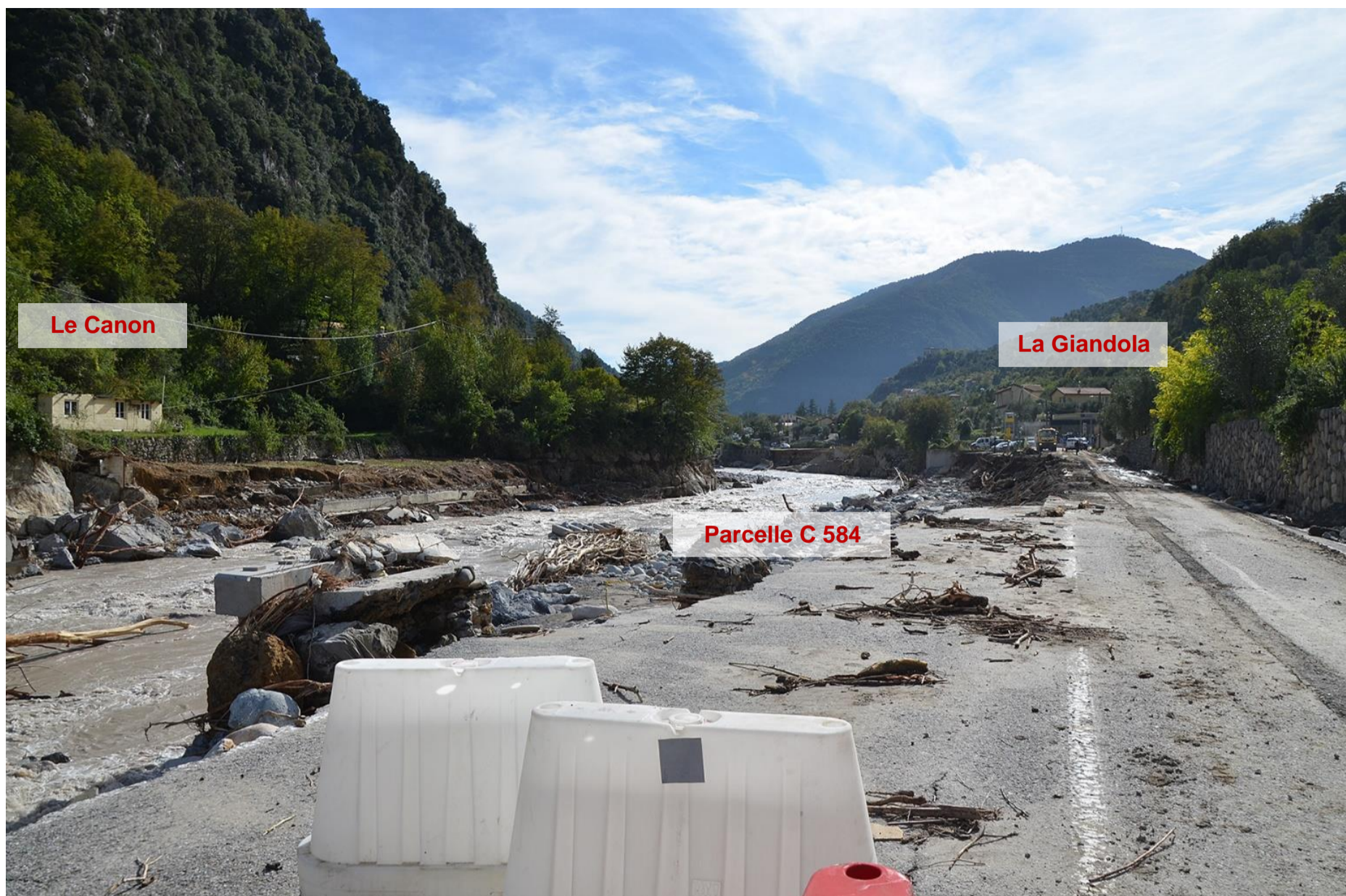
Arrachement de la RD 6204 et de la parcelle C584 au sud de la Tana vu depuis le niveau du Pont de Veil en direction du sud. Octobre 2020.
