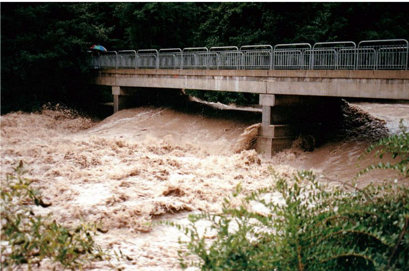
Crue du 13 septembre 1993
