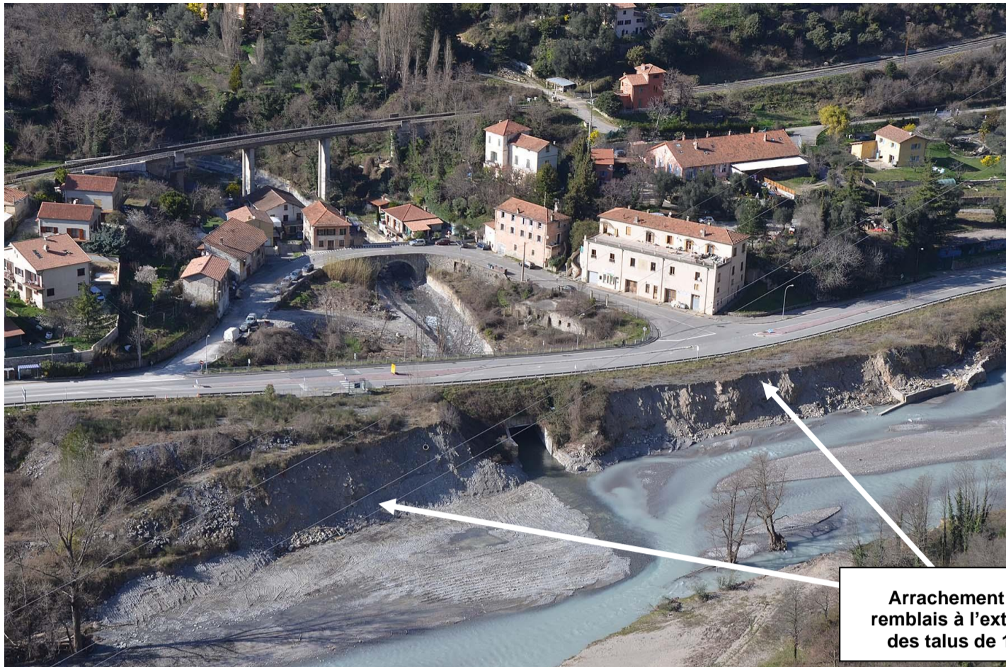
Février 2021. Les remblais talutés à l'extérieur du talus de la route ont été arrachés par la crue du 2 octobre 2020.
