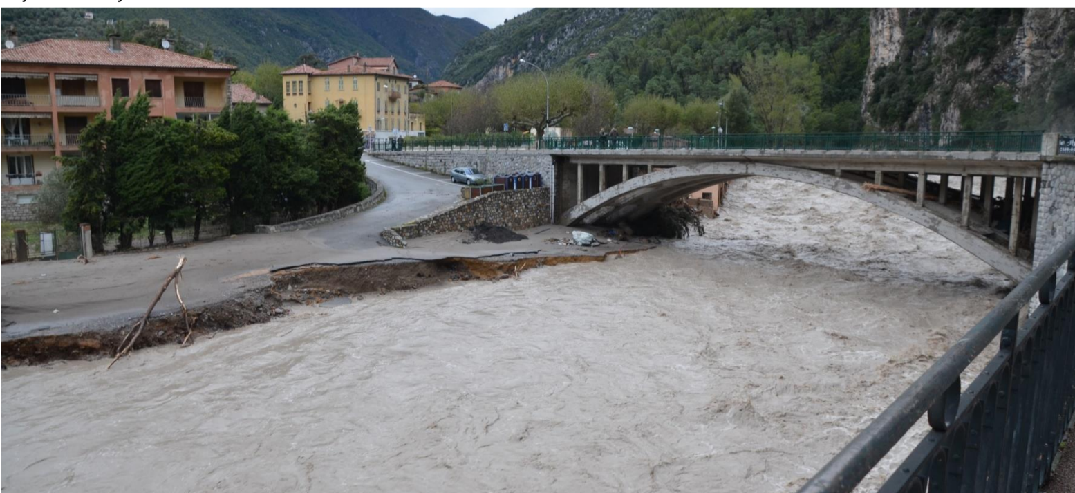
Destruction de la voie sur berge sous le pont Supérieur par la crue de la tempête Alex.
