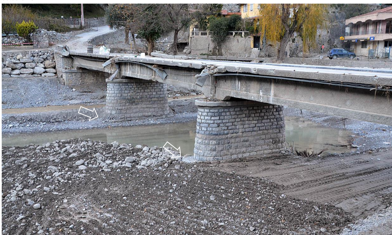
Vue des piles du pont, et du lit purgé une première fois après la crue du 2 octobre 2020 (une montée des eaux ultérieure avait ramené de nouveaux dépôts). On devine le haut de la fondation superficielle des piles (flèches), qui conditionne la réduction de l'ouverture du lit de la Roya.
