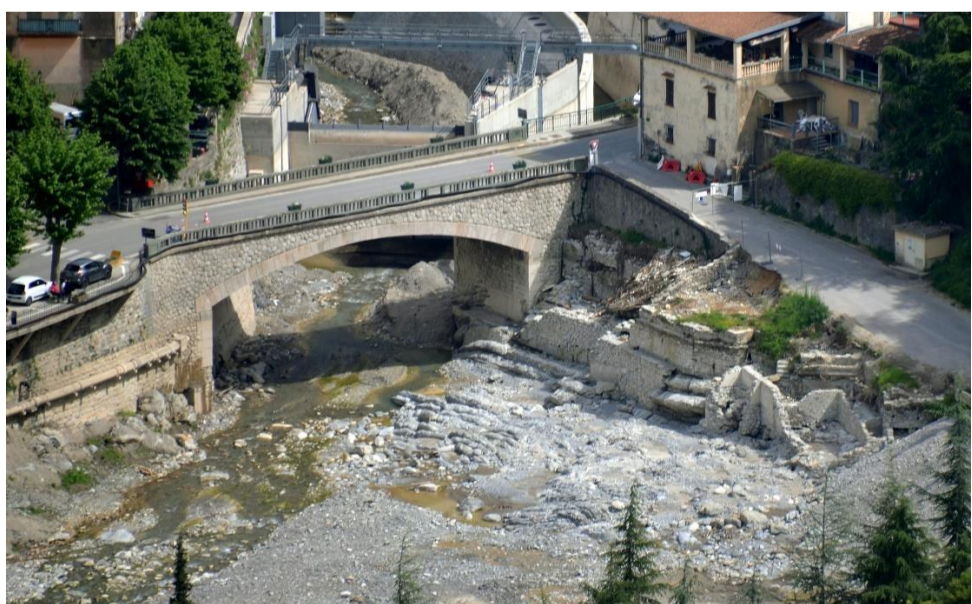
Vue de l'ouverture du pont Inférieur pendant le détournement de la Roya. Mai 2021
