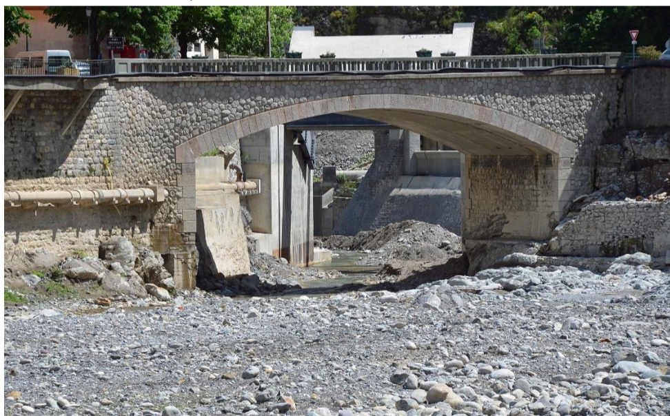
Vue de l'ouverture du pont Inférieur pendant le détournement de la Roya. Mai 2021
